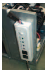
Detección de averías por LEDS
