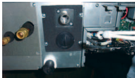
Toma de llenado para tests bomba
